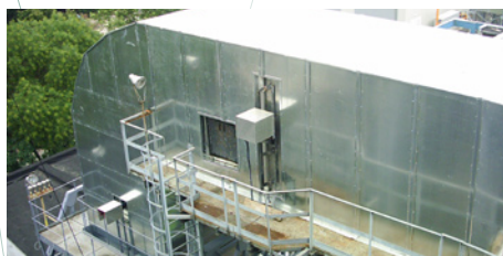
FOTAV – Újpalotai futómű kémény zajcsökkentése
